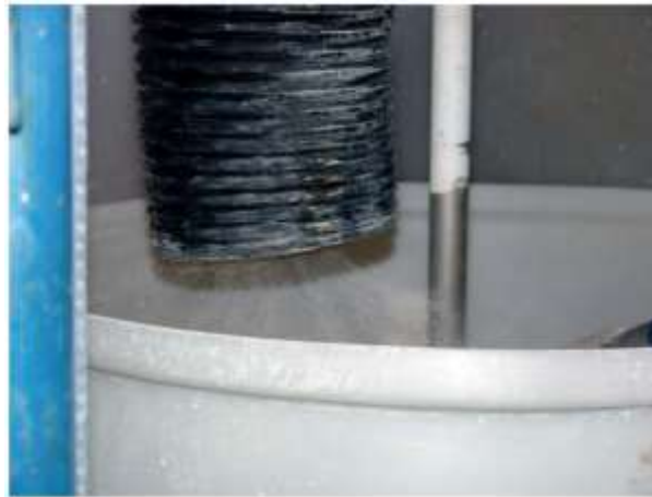
شکل ۸- سامانه تهویه مکنده موضعی که میزان انتشار را کنترل می‌کند (برگرفته از گزارش NIOSH «پیشرفت به سوی نانو فناوری ایمن در محیط کار» [278])
